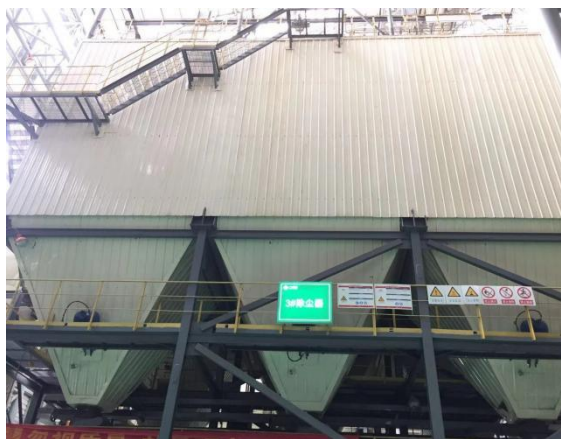
焚烧炉烟气处理-布袋除尘器
