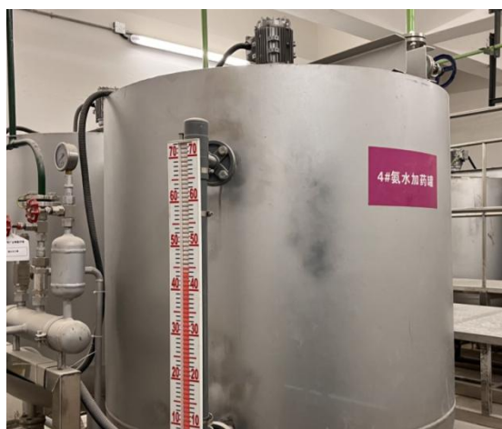
化水间氨水罐
