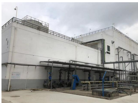
高浓度废水（垃圾渗滤液）处理系统
