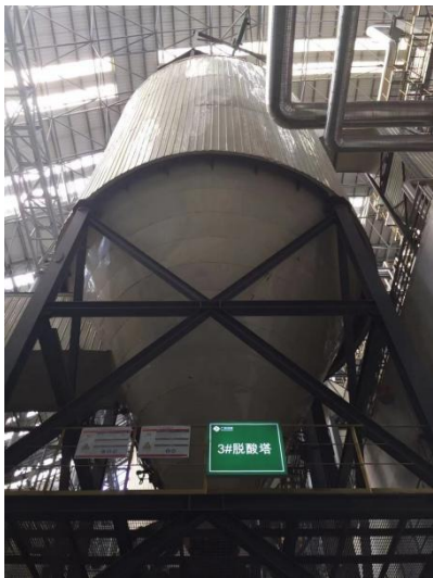
焚烧炉烟气处理-脱酸塔
