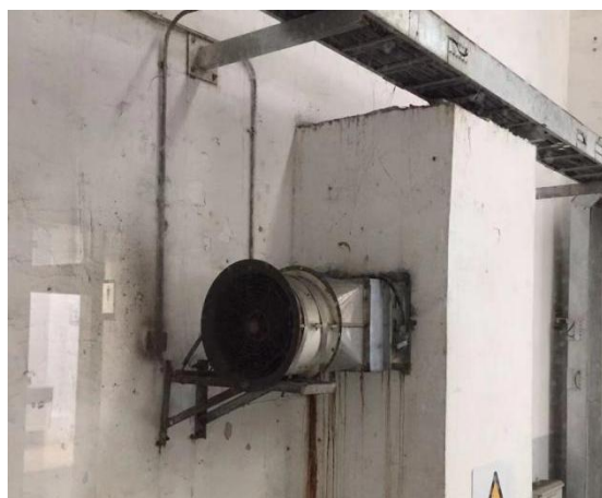
垃圾储坑吸风口
