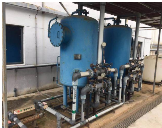
活性炭过滤器
