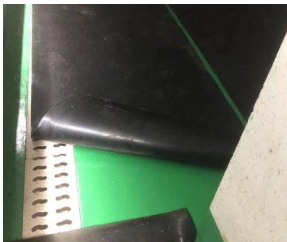
危废间防渗及收集
