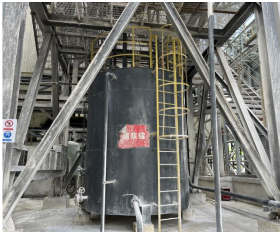
石灰浆制备间
