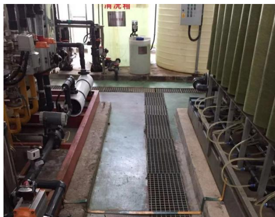
高浓度废水处理设施应急收集
