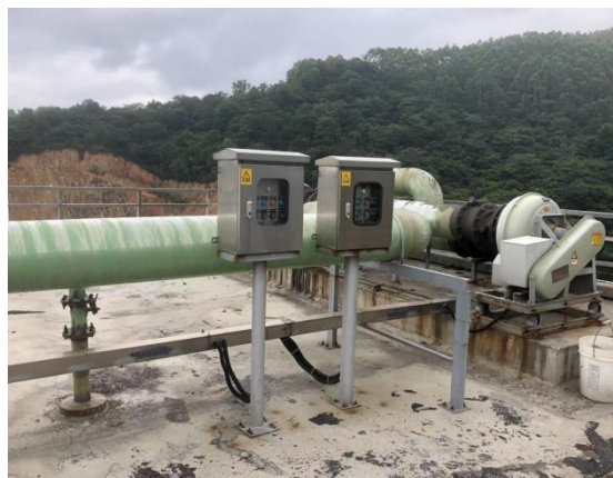
臭气密闭收集装置
